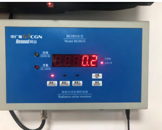
SPECT/CT 机房固定式报警仪
