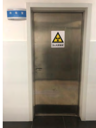
控制区房间防护门上警示标识
