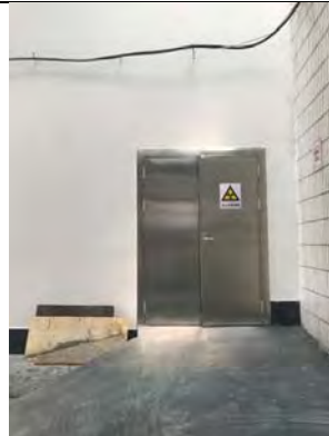
核医学科出口防护门及警示标识
